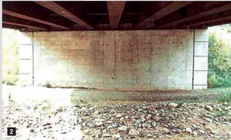
2 Concrete abutment of a bridge in COR-TEN® steel. Spalla in calcestruzzo che supporta ponte in acciaio COR-TEN®.
