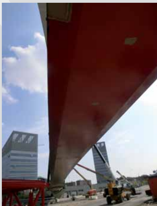
4 Colour sequence from red to grey applied to the bridge. Sequenza dal rosso al grigio applicata al ponte.
